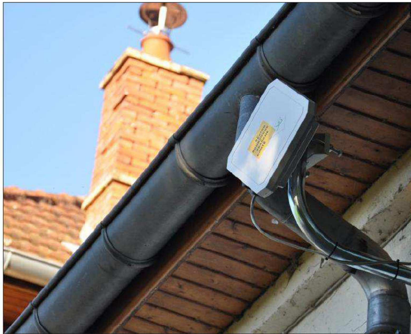
Un récepteur installé sur l'habitation permet de bénéficier du très haut débit via le réseau hertzien RCube de la Région. Ici à la mairie du Planois, qui y est passée il y a un an, avec satisfaction. Photo d'archives JSL/Marie PROTET
